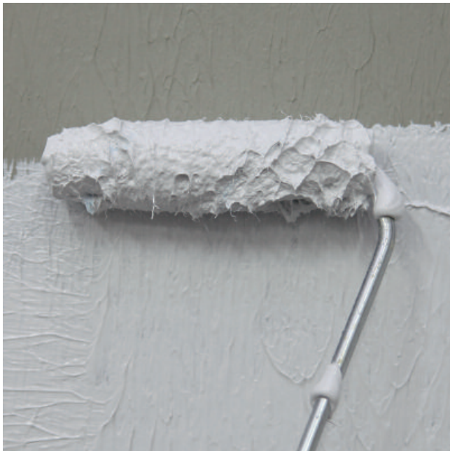
Nachdem die 1. graue Schicht abgetrocknet ist, wird die 2. weiße Schicht mittels Roller (Foto) oder Spachtel aufgetragen.
