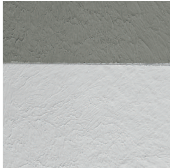
Ausgetrockneter Zustand: Die 2. weiße Schicht überdeckt vollständig die 1. graue Schicht. Mindesttrockenschichtdicke von 0,5 mm erreicht.
